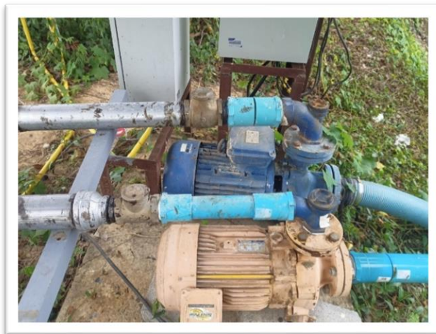
รูปที่ ๒ - ๔ การติดตั้งปั้มน้ำไว้จุดละ ๒ ตัว ไว้สำรองหากเกิดเหตุขัดข้องสามารถเปลี่ยนสลับใช้งานได้ทันที
